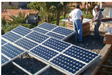
Das Nordotel Tres Vidas in Bahia Feliz installierte eine Photovoltaikanlage mit einer Leistung von 5,7 kW. Geplant ist eine Erweiterung auf 100 kW.
