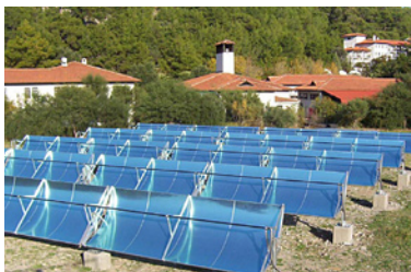
Das Iberotel Sarigerme Park nutzt seit 2004 eine Parabolrinnen-Solaranlage.
